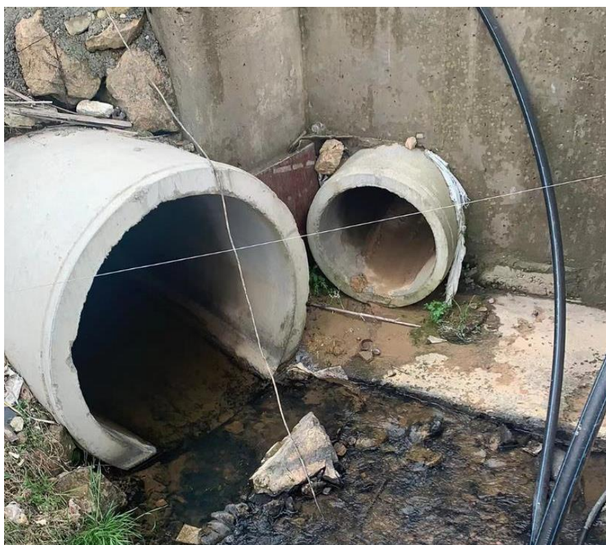
图 6.2-3 松溪弄断口处上游管道
