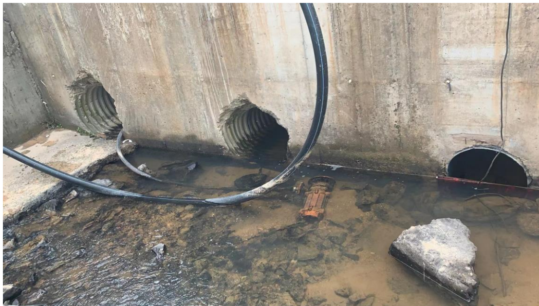
图 6.2-4 松溪弄断口处下游管道
